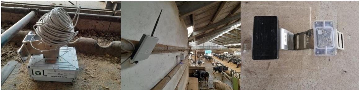
Abbildung 15: links: Antenne A1 vor der Installation mit LAN-Kabel zur Vernetzung mit dem Host-PC, mitte: installierte Bluetooth-Antenne, rechts: Funktionstag (3. Generation) mit Ortungsfunktion und integrierter Lichtdiode zur Erfassung der Beleuchtungsstärke
